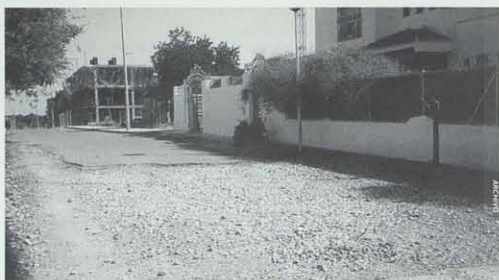
El estado de la calle habla por sí solo. ¿Cuándo podremos circular sin peligro de sufrir accidentes por la calle Castell de Almansa? ¿Qué hace el Ayuntamiento?
